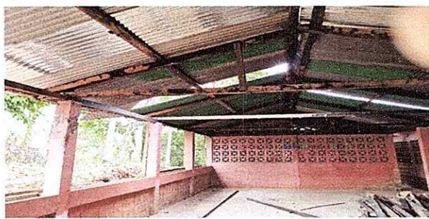
Foto 5: en total deterioro.
